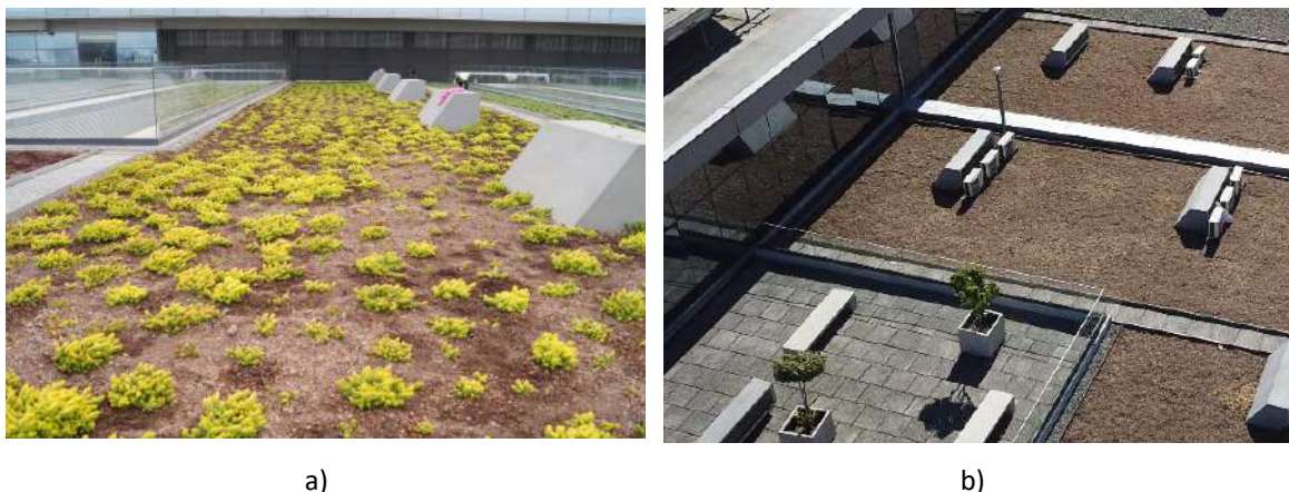
Figura 1.15. Techo vegetativo Hospital Dra. Eloísa Díaz, La Florida, Santiago, Chile. a) Estado techo vegetativo en 2013. b) Estado techo vegetativo en 2018.
