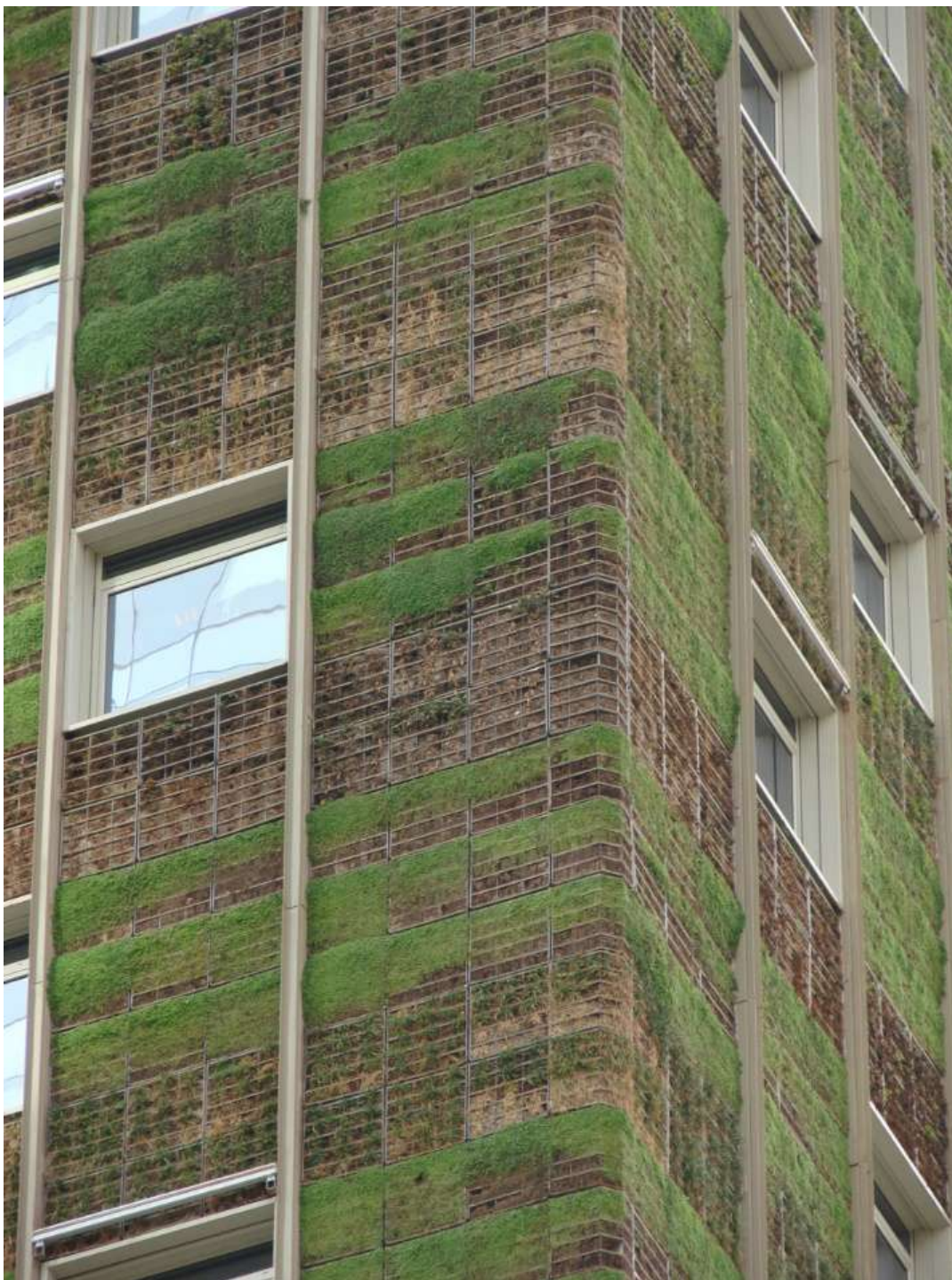
Figura 1.12. Ejemplo deterioro muro vegetativo: Hotel InterContinental, comuna de Las Condes, Santiago, Chile.
