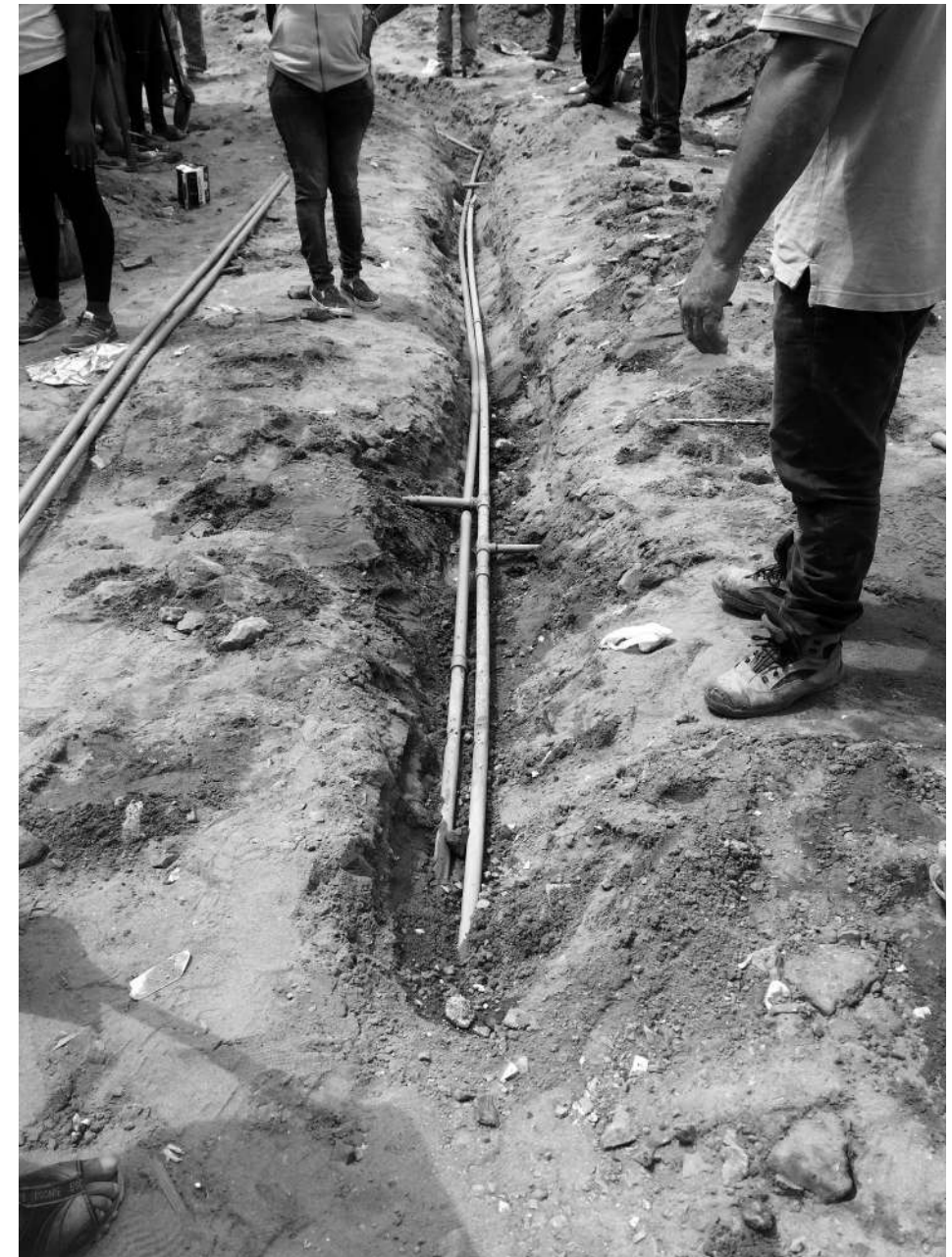
Fig. 2. Tuberías de PVC, canalizando agua a viviendas en el macro-campamento Los Arenales en Antofagasta, Chile (Bayer, 2018).
