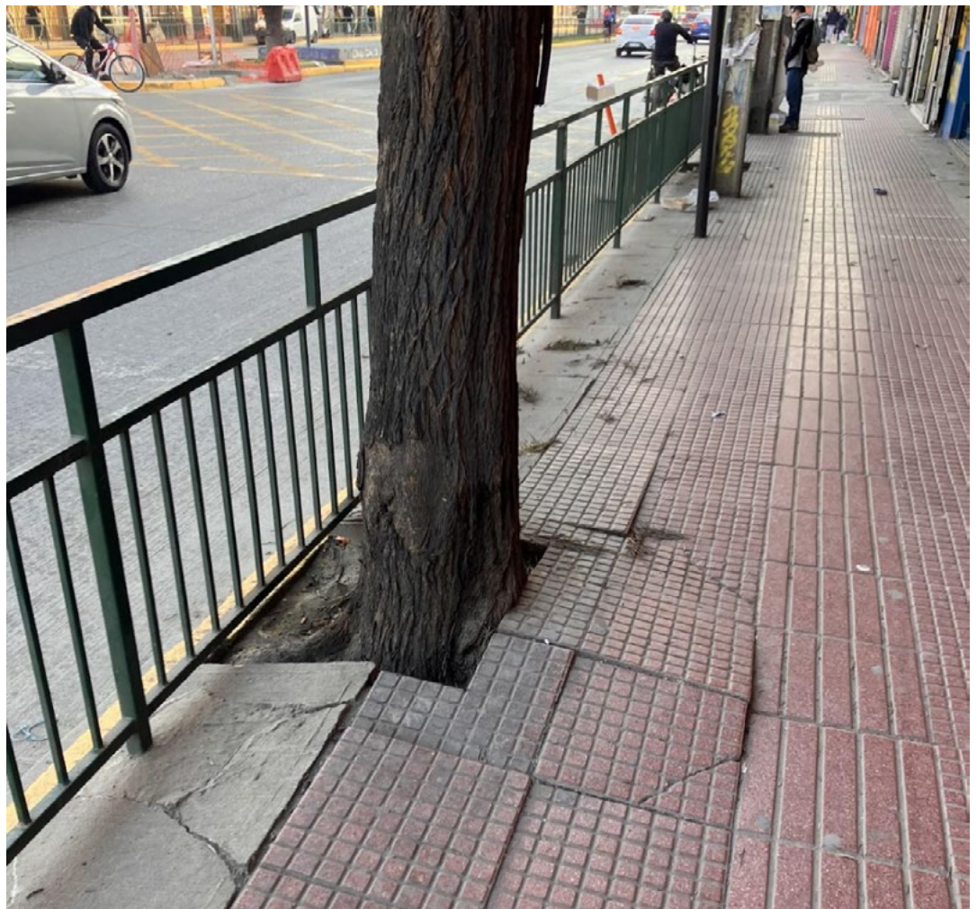
Fig. 12. Veredas en mal estado - Gran Avenida.
