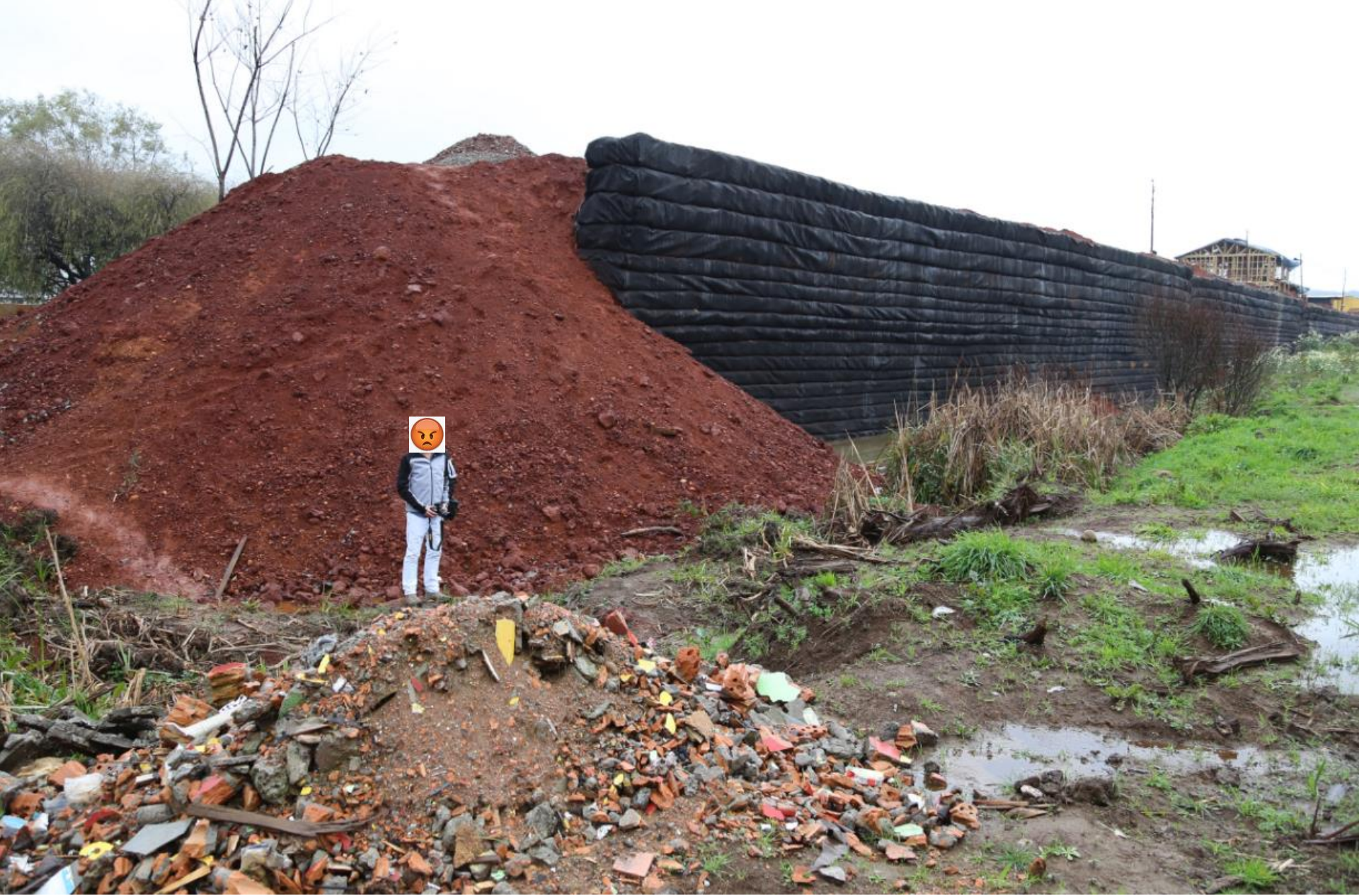
Urbanización sobre relleno de humedales. Construcción de viviendas sociales Nueva Luz - Valdivia. Carolina Rojas
